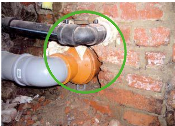
Radoneintrittspfade an unzureichend abgedichteten Leitungsdurchführungen
